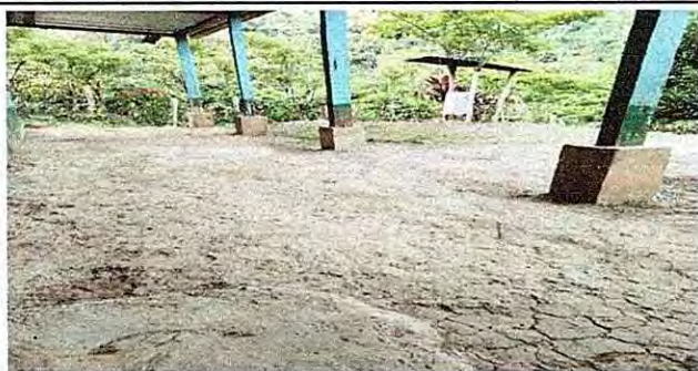
Foto 5: En esta fotografia se puede observar la parte del corredor del Establecimiento, en la cual el piso granito quedo aplazado.
