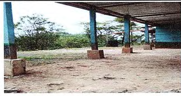
Foto 6: En esta fotografia se puede observar la parte del corredor del Establecimiento, en la cual el piso granito quedo aplazado.
