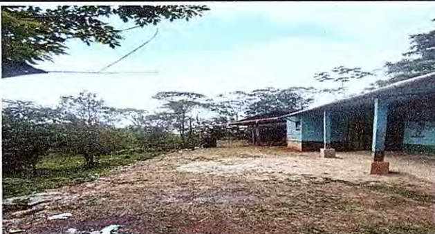
Foto 4: En esta fotografia se puede observar la parte de enfrente del Establecimiento, en la cual la losa de patio esta inconclusa y el deterioro de la misma.
