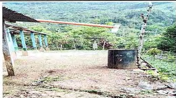
Foto1: En esta fotografia se observa el Deposito del agua del Establecimiento y el deterioro de la misma.
